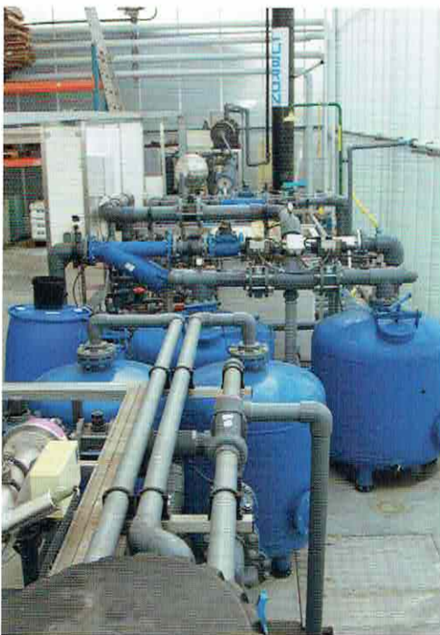
Valstar ontsmet drainwater, houdt silo's en leidingen schoon en belucht water in mengbak.
